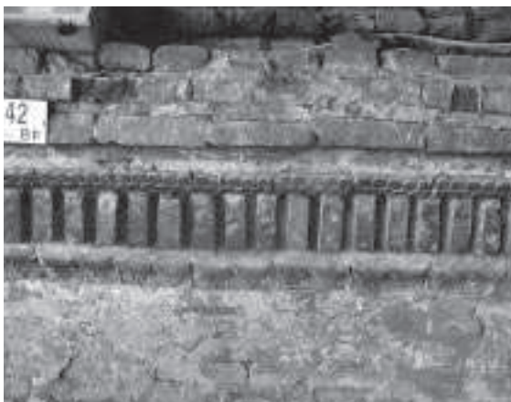
A DESTRA, pronao, interno del vano della volta centrale dopo la pulitura ed un blando consolidamento dei giunti di malta.
